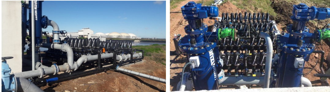
Fig. 3 Imagen de la Estación de acondicionamiento
