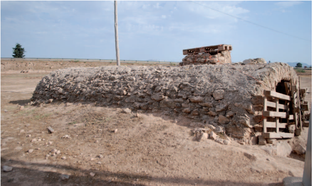
Fig.3. Aljibe de vaso rectangular y bóveda de cañón, muy deteriorado como la mayor parte de los aljibes del Campo de Cartagena. Fuente Álamo
