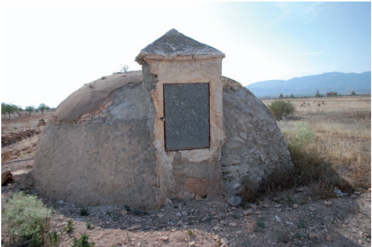
Fig. 2. Aljibe de vaso cilíndrico y cúpula de casquete esférico. Paraje Los Hanghes. C a de El Escobar a Fuente Álamo
