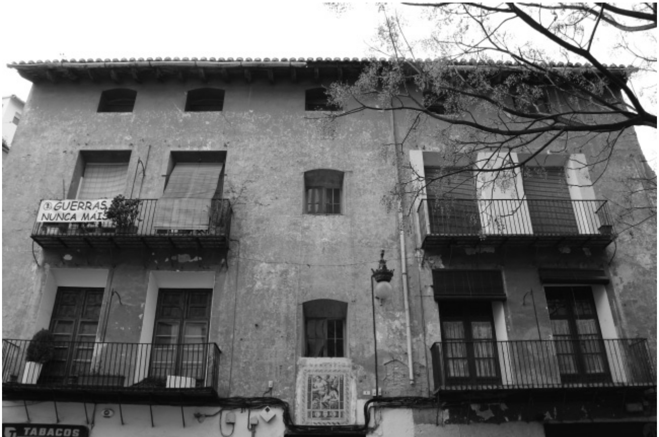
Fig. 6a (La Spina) Detalle del acabado superficial de la fachada con revestimiento histórico
