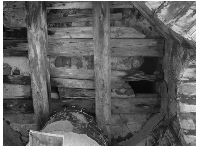
Figura 8. Imagen del estado de degradación de la estructura lígnea de la torre-campanario (Mileto & Vegas)
