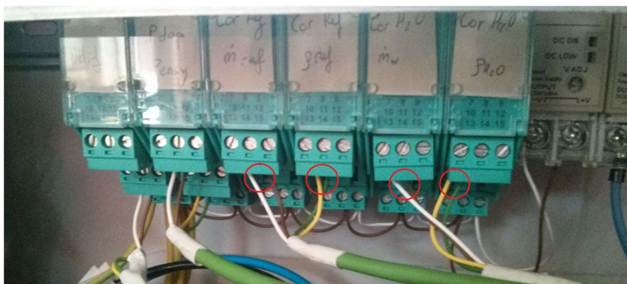
Figura 60. Conexión caudalímetros en barreras.
