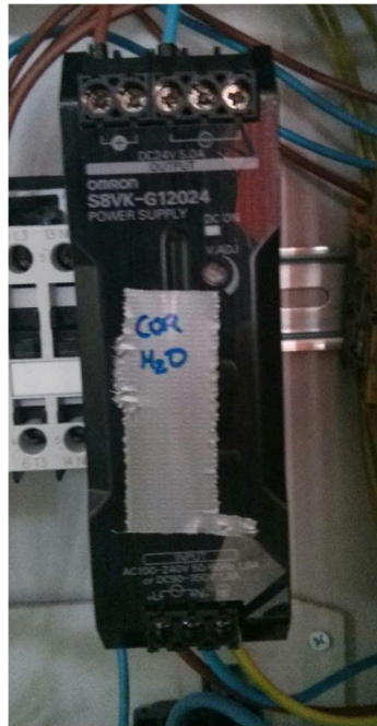
Figura 63. Fuente de alimentación del caudalímetro coriolis del circuito de refrigeración primario.
