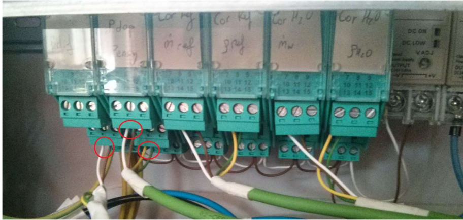
Figura 61. Conexión sensores de presión en barreras.
