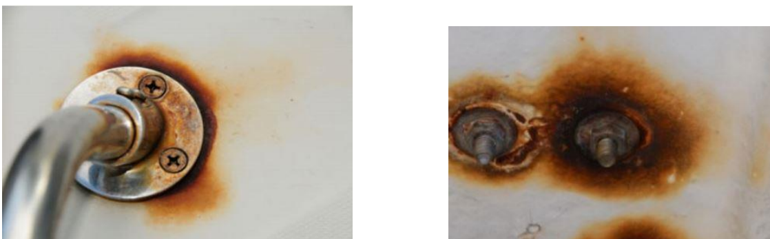
Figura 4. Ejemplos de corrosión en resquicio
