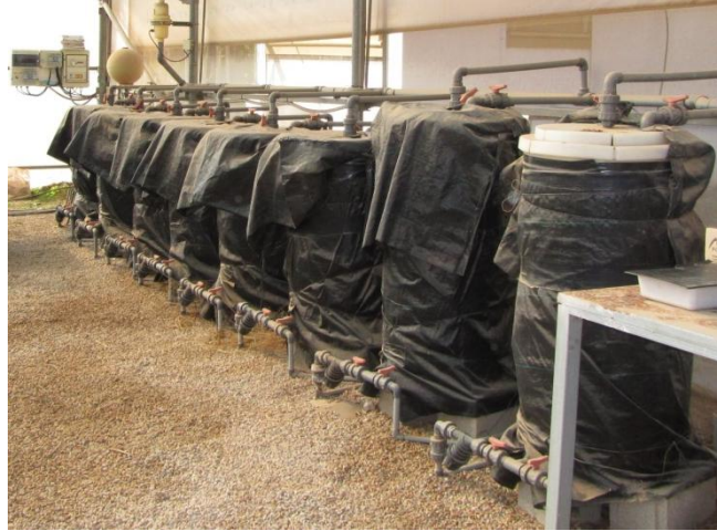
Ilustración 5 Disposición de los tanques en el interior del invernadero.
