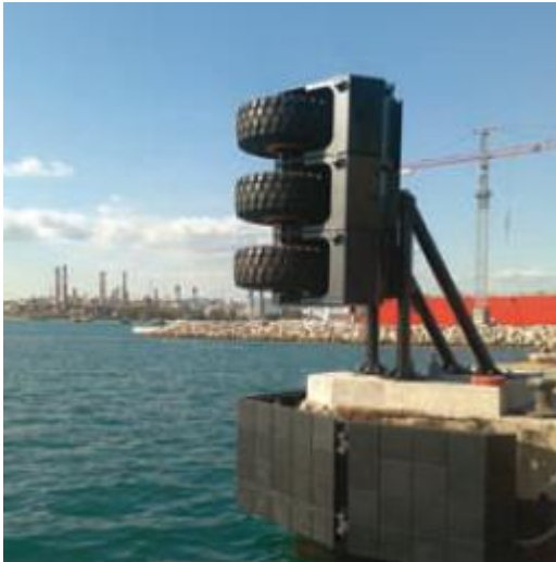
DEFENSAS DE ESQUINA
