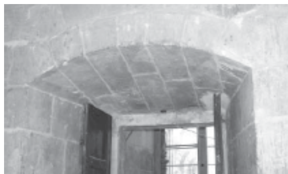
Fig. 1. Capialzado en la Torre de la Catedral de Murcia. Fotografía de José Calvo.
