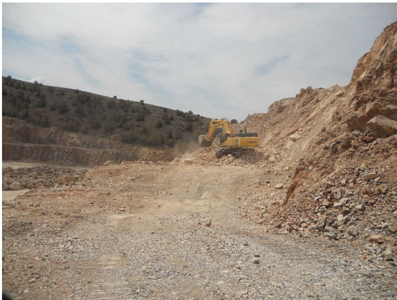
Imagen 7-3. La retroexcavadora sobre la pila de material a una altura aprox. de 3 metros, volviendo a la posición de la primera imagen para realizar la carga de material.
