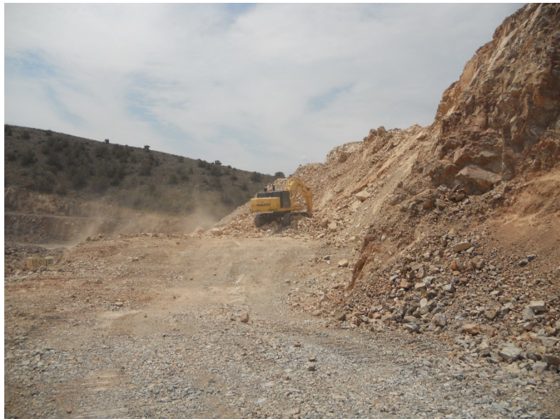
Imagen 7-1. La retroexcavadora sobre la pila de material a una altura aprox. de 3 metros, realizando la carga de material.
