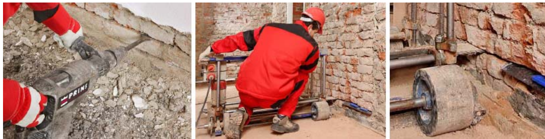
Fase 1.- corte transversal de la fábrica de ladrillo macizo para poder introducir la lámina impermeable (emplomado o PVC)
