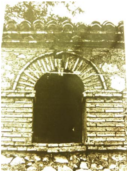
Estado de un arco de ventana de la fachada principal Imagen cedida por el Servicio Patrimonio Histórico
