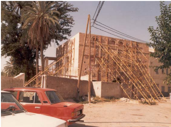
Vista exterior del edificio durante la ejecución de la restauración. Imagen cedida por archivo municipal de Alcantarilla.
