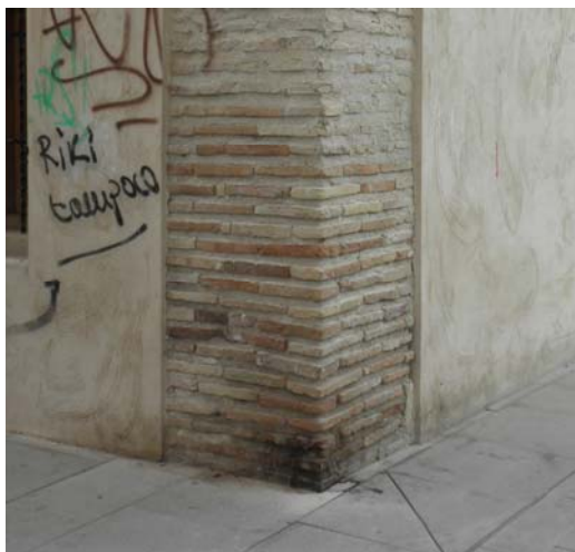
Una de las esquinas del edificio donde aparece proceso de biodeterioro .
