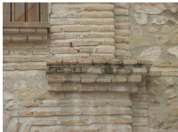
Estado actual del estado de cornisas. Se pueden apreciar escorrentías en la fachada inmediatamente después de llover en el municipio
