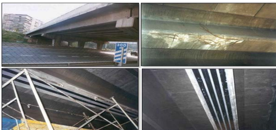
Figura 1. 6 Reparación de Estructuras de hormigón con laminados de fibra de carbono. Reparación del tablero del puente de la Avda de S.Luis, sobre la M-30.
