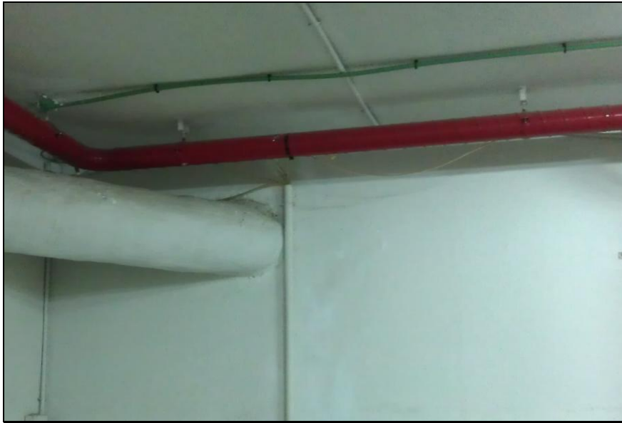
Foto 7.14 Tramo recto y codo
