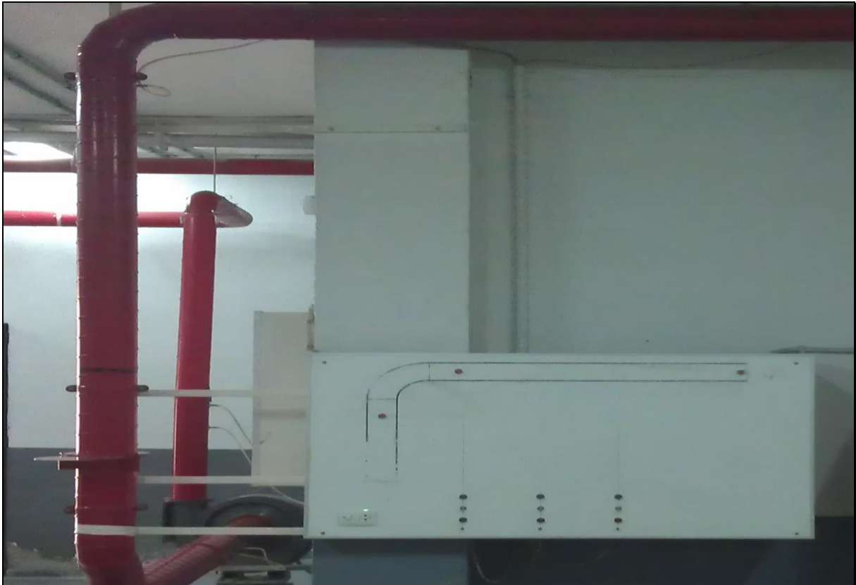
Foto 7.18 Tramo recto y codo
