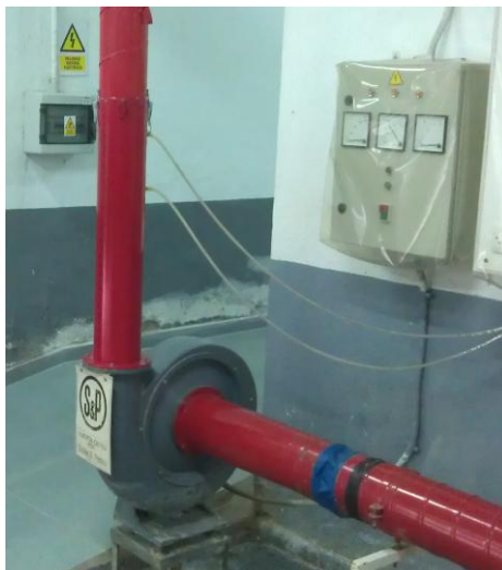
Foto 7.4 Ventilador aspiración e impulsión y cuadro eléctrico
