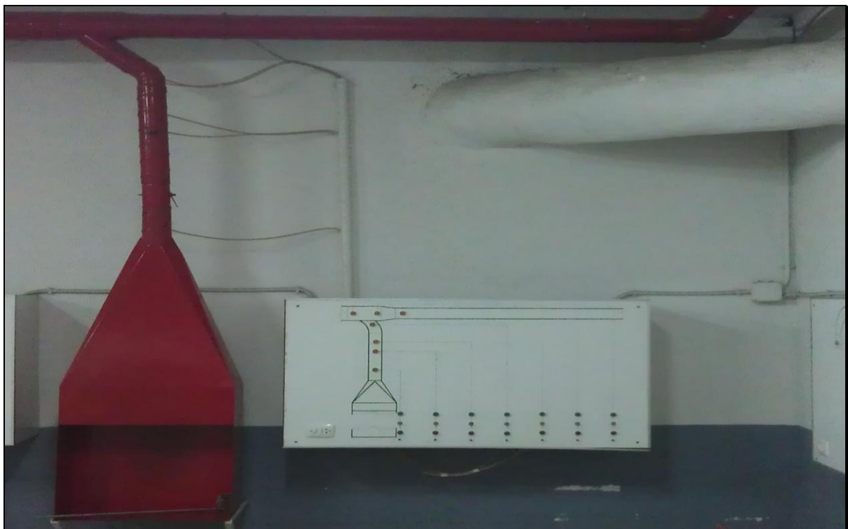
Foto 7.16 Punto n° 5 de la aspiración campana
