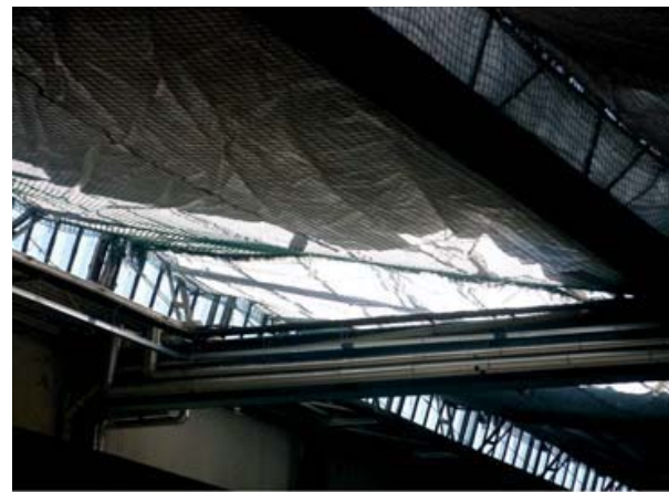
Figura A3.4 Colocación de una lámina de plástico para recoger residuos que puedan caer durante la retirada de una cubierta de fibrocemento.
