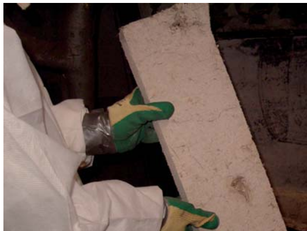
Figura A3.21 Retirada de bloques enteros de MCA. friable, uno a uno, de un aislamiento térmico
