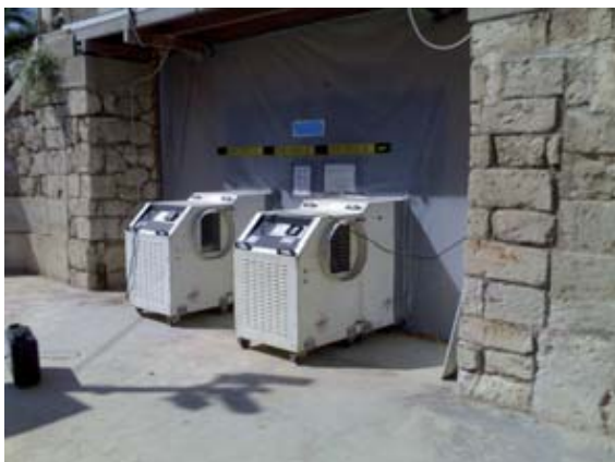
Figura A3.8 Extractores de aire para generar presión negativa en el interior de una burbuja
