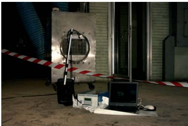
Figura A3.10 Mediciones de control del aire en el exterior de la burbuja
