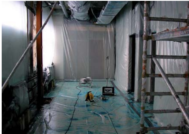
Figura A3.25 Muestreo de aire en el interior de la burbuja después de la limpieza y aplicación del fijador
