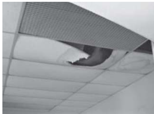
Figura 6. Placas de falso techo con contenido en amianto
