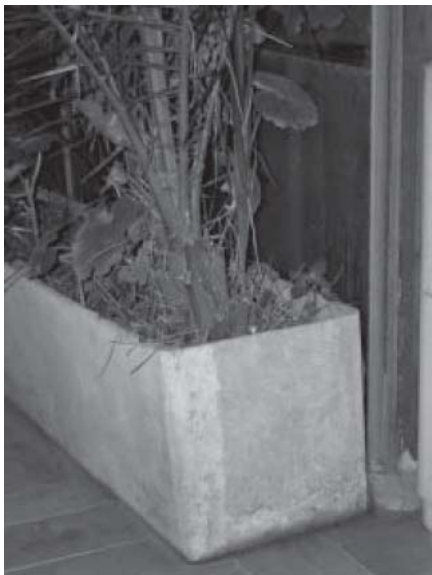
Figura 3. Exposición en interior de edificios: jardinera de fibrocemento
