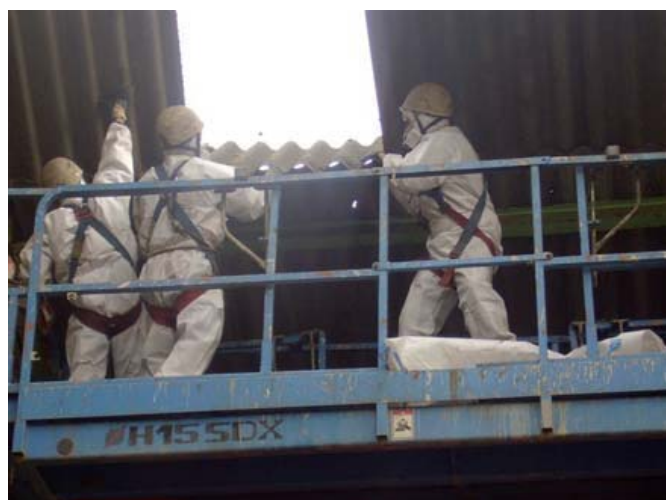
Figura A3.22 Desmontaje de piezas enteras para la retirada de una cubierta de fibrocemento
