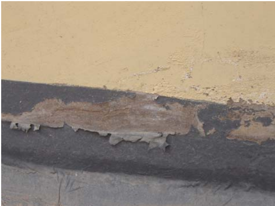
Desprendimiento del revestimiento
