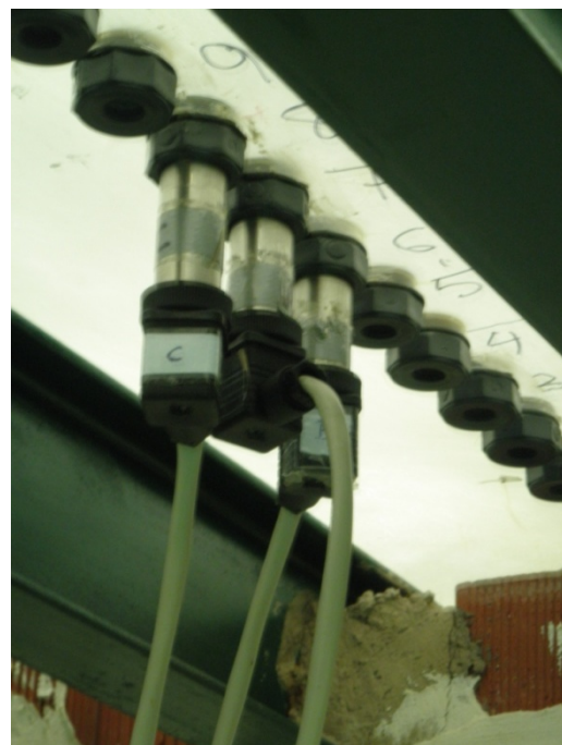
Figura 3.9. Sensores de presión instalados.
