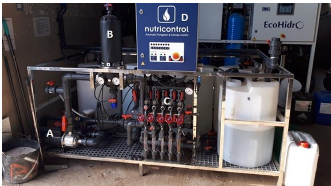
Figura 3. Cabezal de riego experimental. (A) Sistema de bombeo; (B) Sistema de filtrado; (C) Subsistema hidráulico; (D) Autómata de control.
