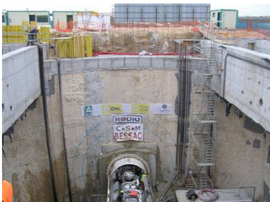
Fig. 7. Boca de entrada y túnel en la Nueva Desaladora del Canal de Alicante.
