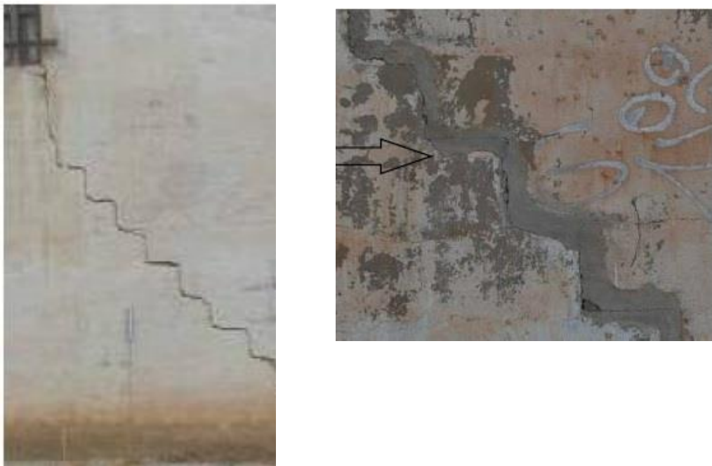
Fig. 21 – Continuación de imágenes de grietas. La imagen de la izquierda es del año 2005 y la de la derecha es del año 2009 (se observa como la grieta a pesar de haber sido sellada con cemento vuelve a abrirse).
