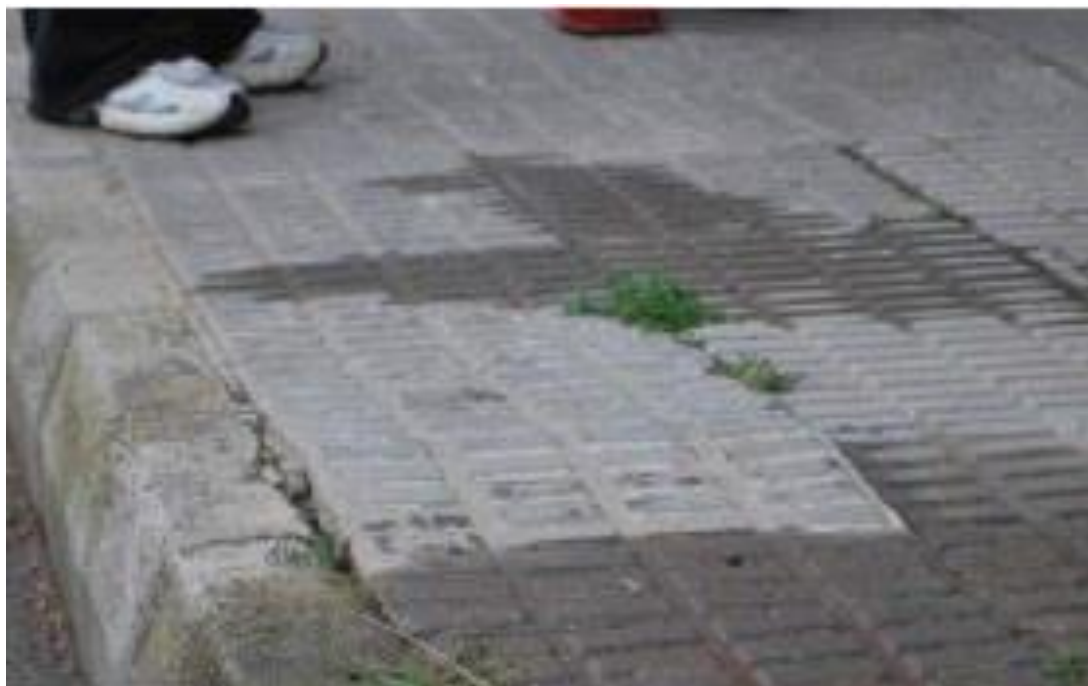
Fig. 22 – Deformación de baldosa debida a la subsidencia minera.
