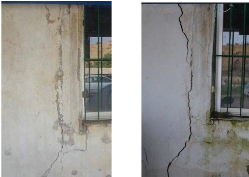
Fig. 20 – Imágenes de grietas causadas por efecto de la subsidencia minera en el polígono de Lo Tacón. La imagen de la izquierda es del año 2005 y la de la derecha es del año 2009 (puede verse la evolución que ha tenido dicha grieta).
