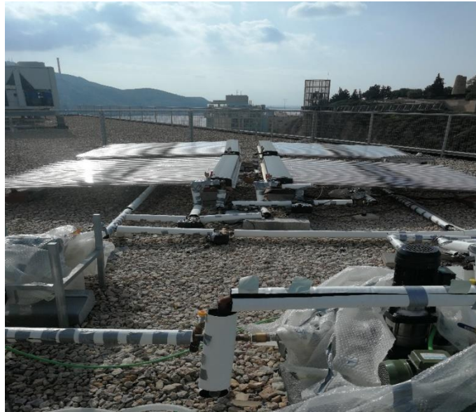
Figura 34. Disposición colectores solares Vitosol 300-TM
