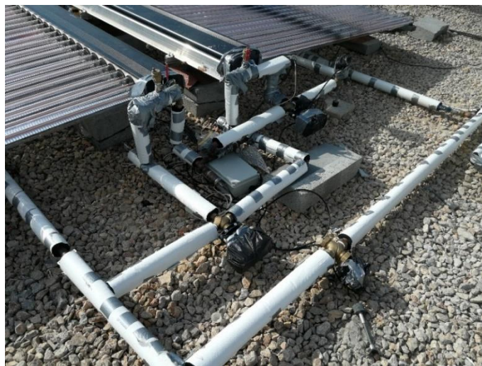
Figura 35. Sistema de válvulas para cada pareja de colectores solares
