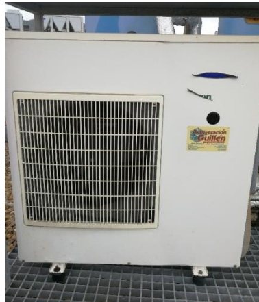
Figura 50. Enfriadora Carrier 30RA009
