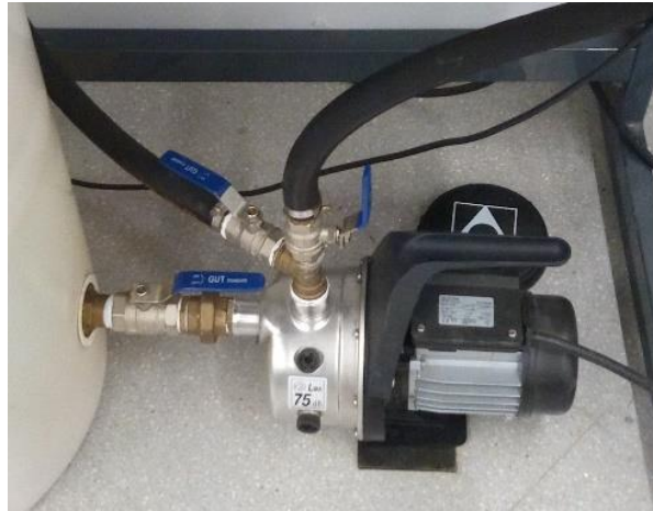
Figura 3. Bomba centrífuga de impulsión
