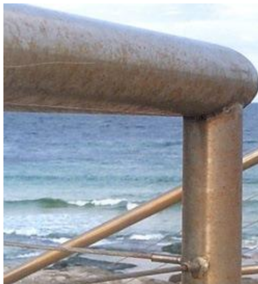
Figura 11. Acero inoxidable corroído
