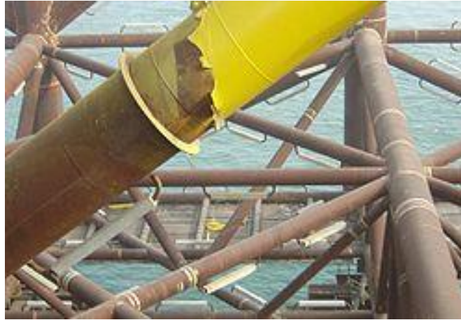
Figura 12. Recubrimiento fallido por falta de adherencia
