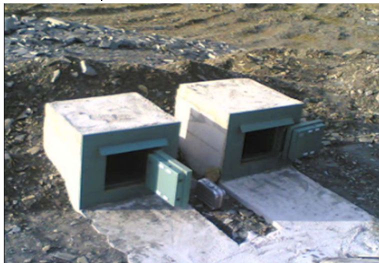
Ilustración 7. Minipolvorines de almacenamiento
