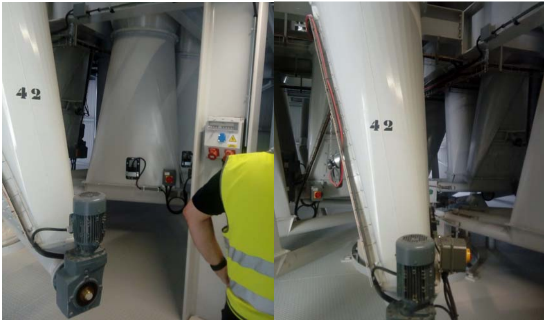
Figuras 46, 47. Detalle descarga silos de materias primas
