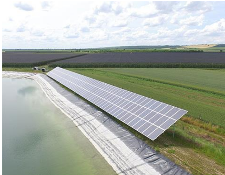
Figura 3.12 Módulos fotovoltaicos instalados cerca de embalse. Fuente: Tonkasolar
