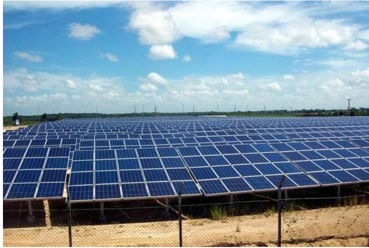
Figura 4.3 Generador fotovoltaico. Fuente: Radiorebelde
