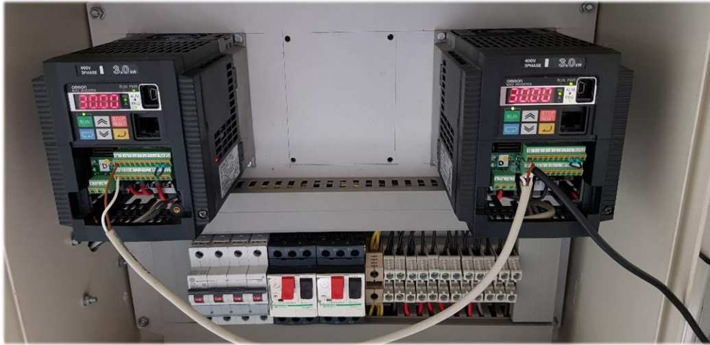
Ilustración 16. Variadores de frecuencia 3G3MX2-A4030-E de Omron
