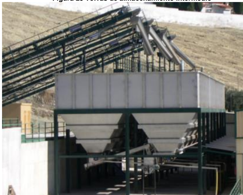
Figura 25 Tolvas de almacenamiento intermedio
