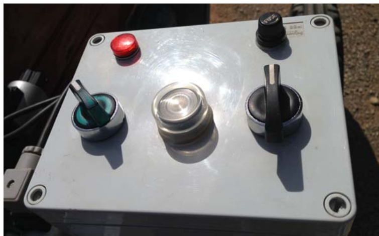
Figura 12. Cuadro eléctrico para mando manual.
