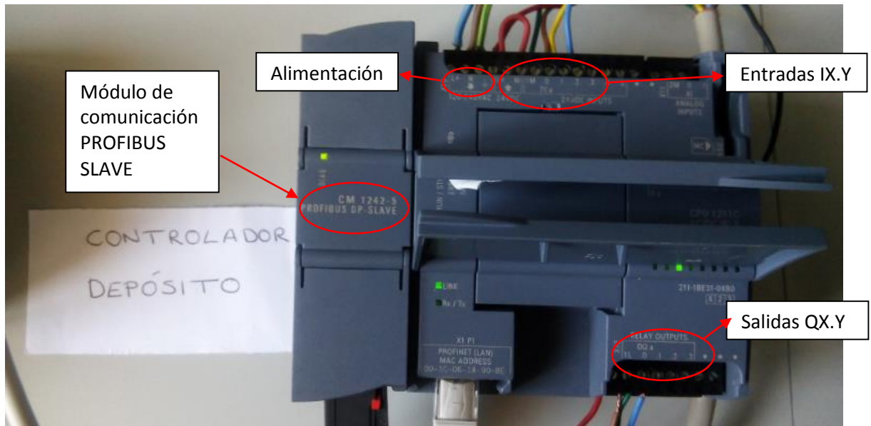
Figura 28: PLC Controlador Depósito.
