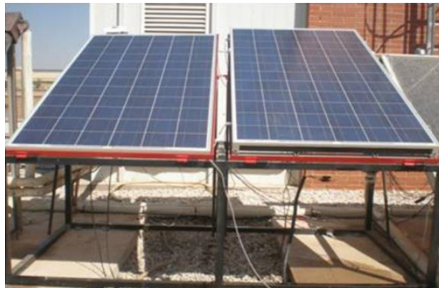
Figura 2.4. Instalación experimental. Panel simple (izquierda), panel con canal de refrigeración (derecha) (Mazón, 2014)
