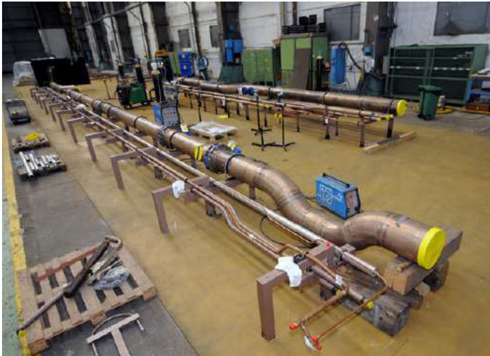
Figura 4. 25.Haz de tubería.
