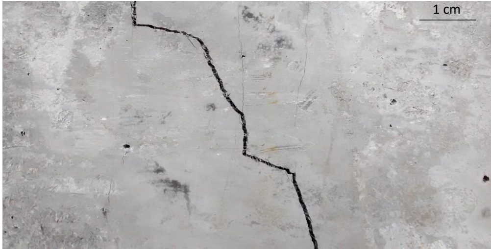
Ilustración 5.9 Patrón de rotura
