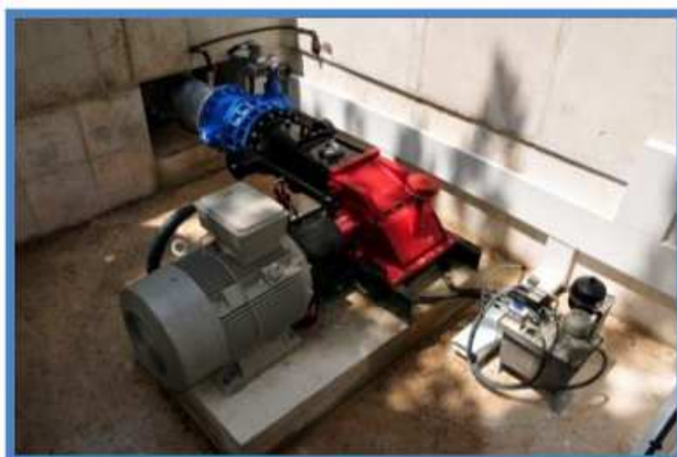
Figura 11: Turbina de flujo cruzado instalada en la microhidraulica de EL QUIEBRE, fuente AQUALOGY.
