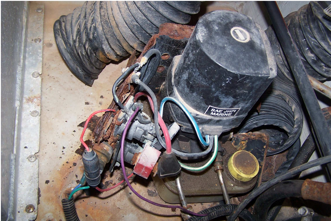
Figura 14: Cableado en mal estado en una embarcación Baja 290.
