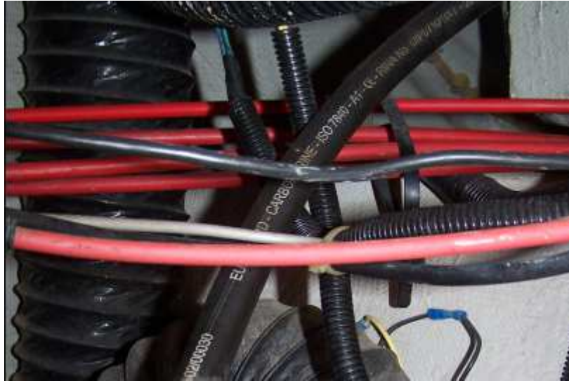
Figura 23: Detalle del cableado.
