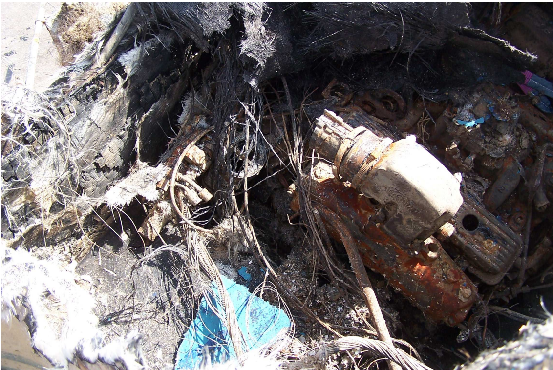
Figura 15: Cámara de máquinas del Barba tras su recuperación.
