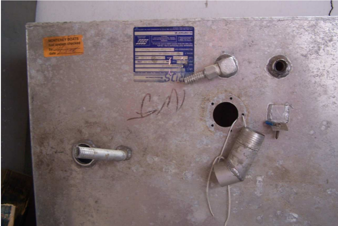
Figura 41: Manguera de llenado desprendida de otro depósito similar.
