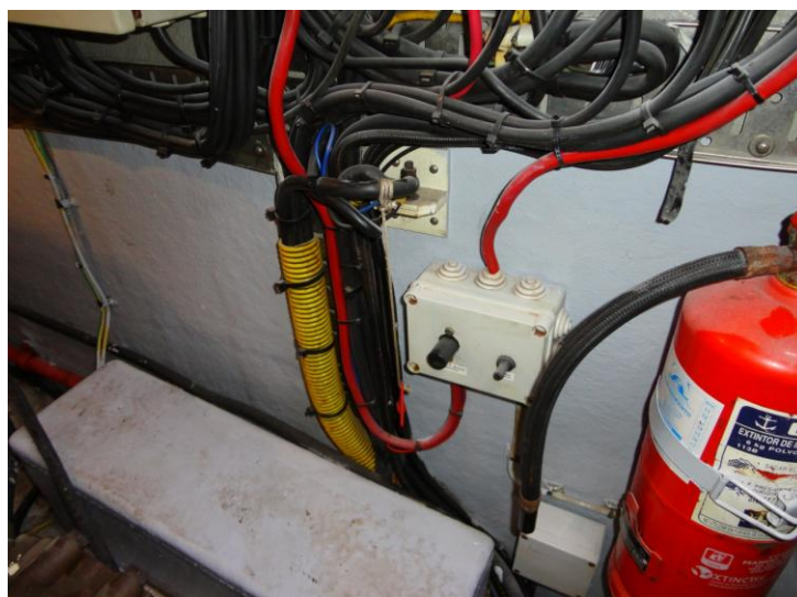
Disposición del cableado en cámara de maquinas.
