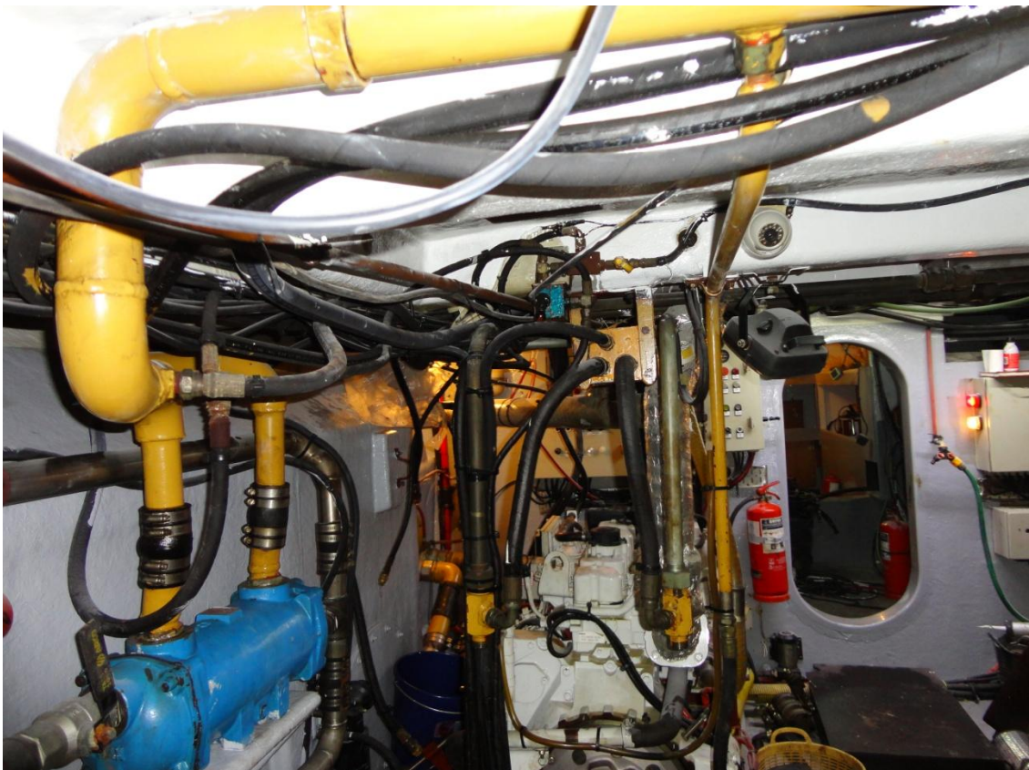
Situación de los generadores en cámara de maquinas.
