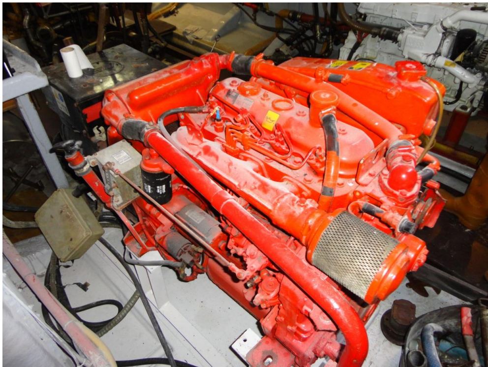
Generador eléctrico principal.
