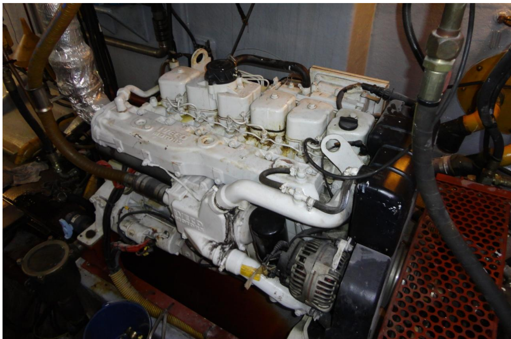
Generador eléctrico de emergencia.
