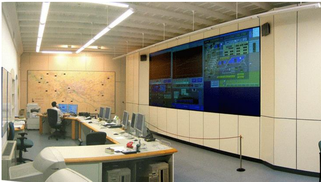
Figura 22. Vista del SCADA del Puesto de Control de EMASESA (Empresa Metropolitana de Abastecimiento y Saneamiento de Aguas de Sevilla S.A)
