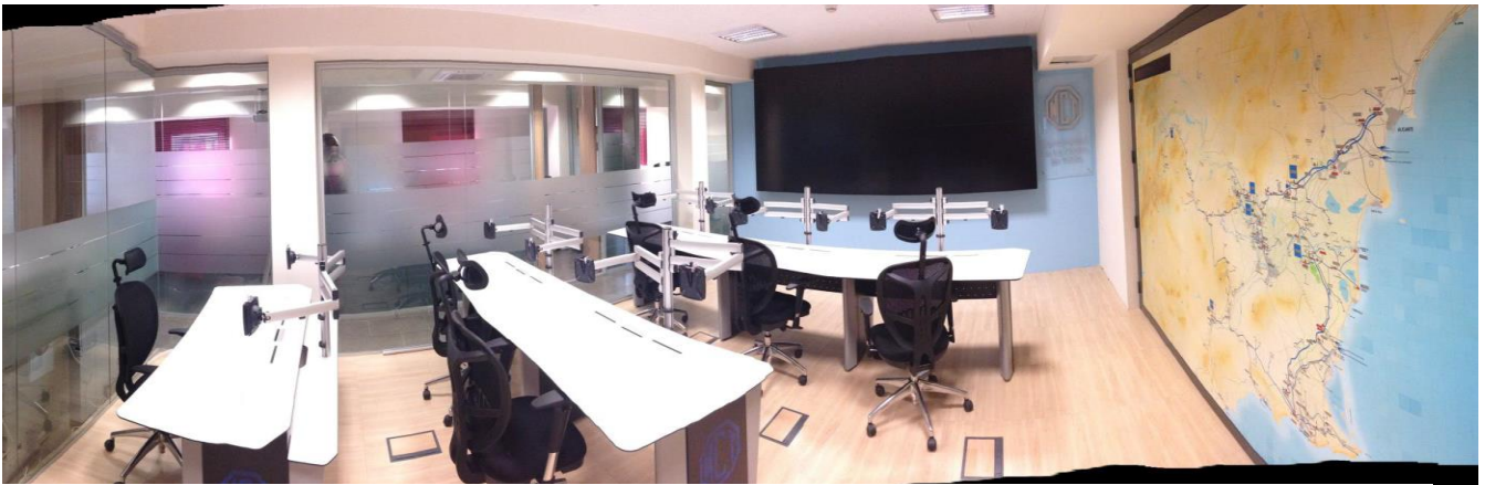
Figura 21. Puesto central SCADA de la MCT en Cartagena
