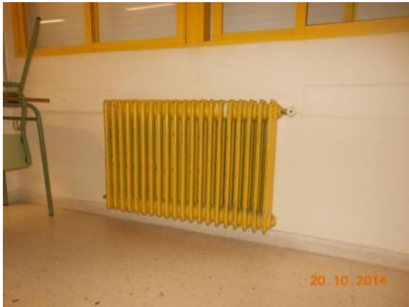
Figura 10: detalle radiador existente. Edificio antiguo
