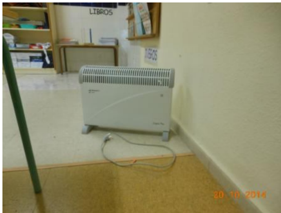
Figura 12: detalle radiador existente. Edificio nuevo
