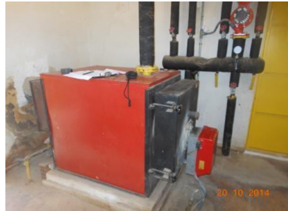
Figura 11: detalle caldera existente. Edificio antiguo
