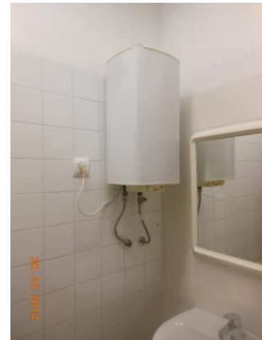
Figura 13: Termo eléctrico en uno de los aseos
