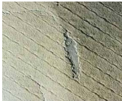
Figura 4.8. Scaling sobre la superficie de la membrana (DOW, 2009)
