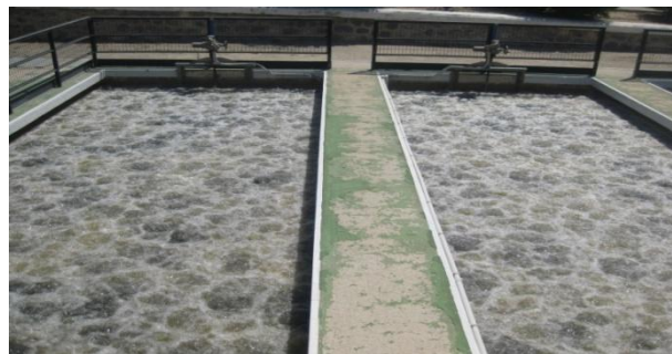
Figura 4.5. Instante actuación soplantes de aire
