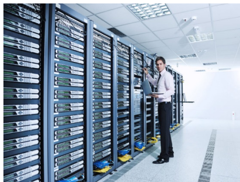
Imagen 2. Operarios 24/7 en CPD.
