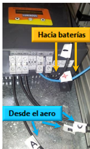
Figura 4-3 Conexión aerogenerador controlador y baterías.
