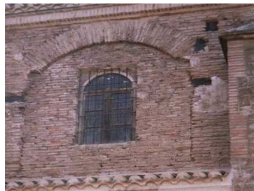
Fig. 20. Desprendimiento de ladrillos.
