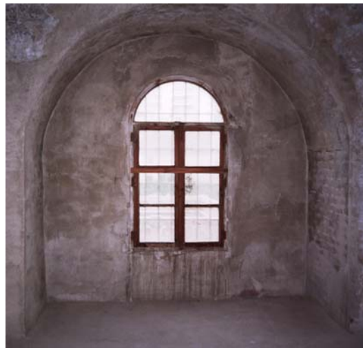
Fig. 22. Fenómeno de espectro de juntas en el interior de la iglesia.
