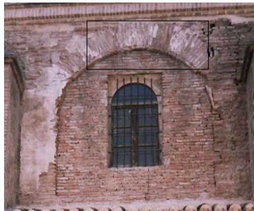
Fig. 27. Eflorescencia visible en forma de manchas blancuzcas en el ladrillo.
