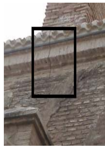
Fig. 4. Fisuras por cargas centradas.
