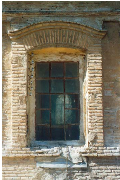
Fig. 23. El ladrillo erosionado es una de las constantes de la fachada Norte de la iglesia, perdiendo casi sus dimensiones y forma original, todo ello debido a un proceso lento, de muchos años.
