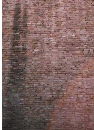
Fig. 6. Humedad por filtración del agua de lluvia (fenómeno de capilaridad).
