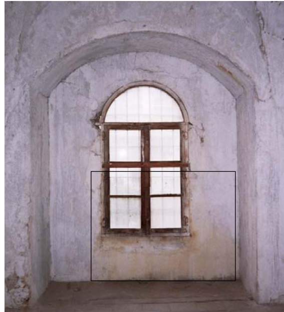
Fig.11. Oxidación electroquímica por infiltración del agua de lluvia de los elementos metálicos de la ventana en el interior de la fachada Norte de la iglesia.
