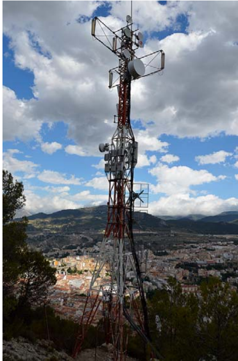
Figura 57. Torre de telecomunicaciones.
