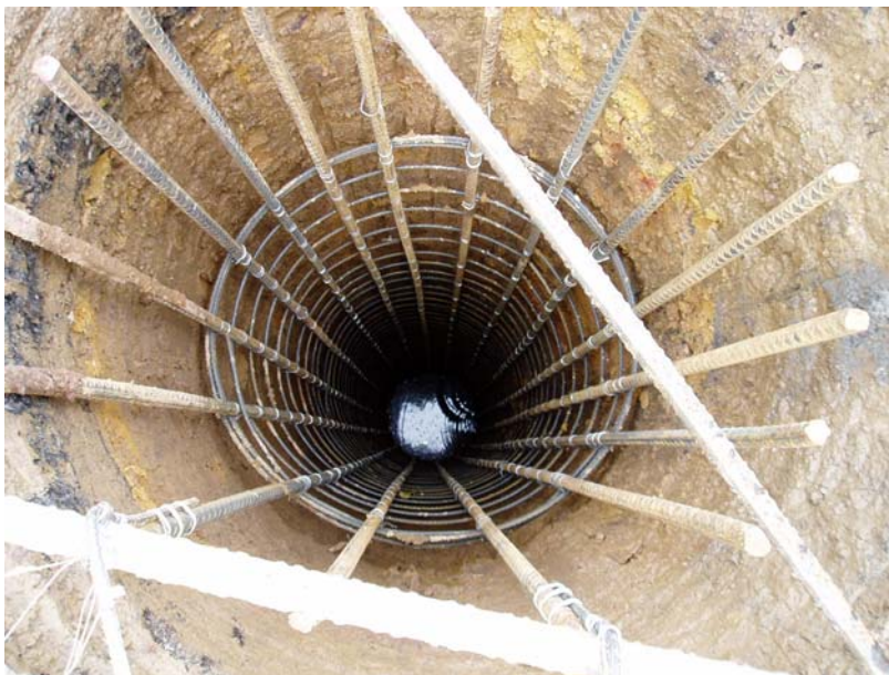
Fig. 3. Presencia de agua en pilote 30
