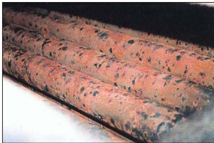
Corrosión por Pitting
