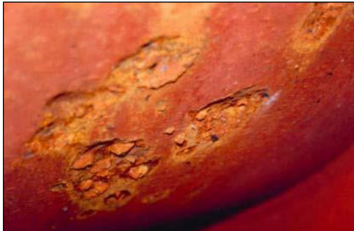
Corrosión por Caústica
