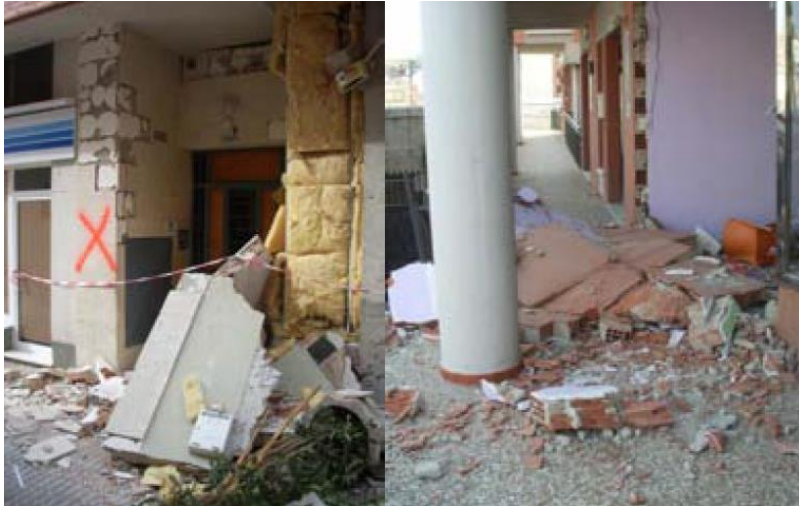
Figure 1 Nonstructural failure in Lorca. 2011. (Informe del sismo en Lorca del 11 de mayo de 2011).
