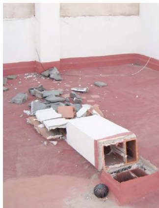
Figure 37 Collapse of a chimney on the roof of a building (Revista Zuncho. Nº30. Diciembre 2011. Especial Sismo)
