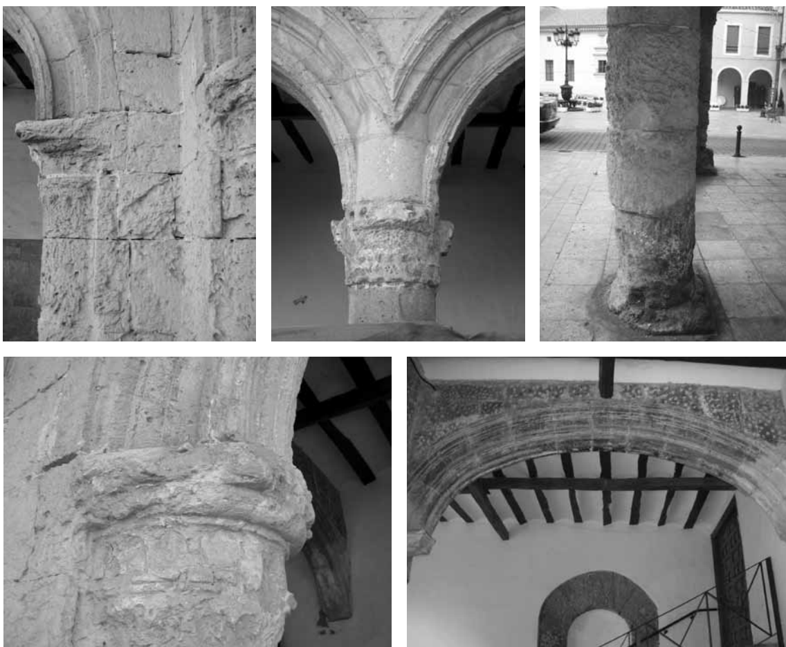
Figura 2. Ejemplos de alteración y disgregación atmosférica en sillares.
