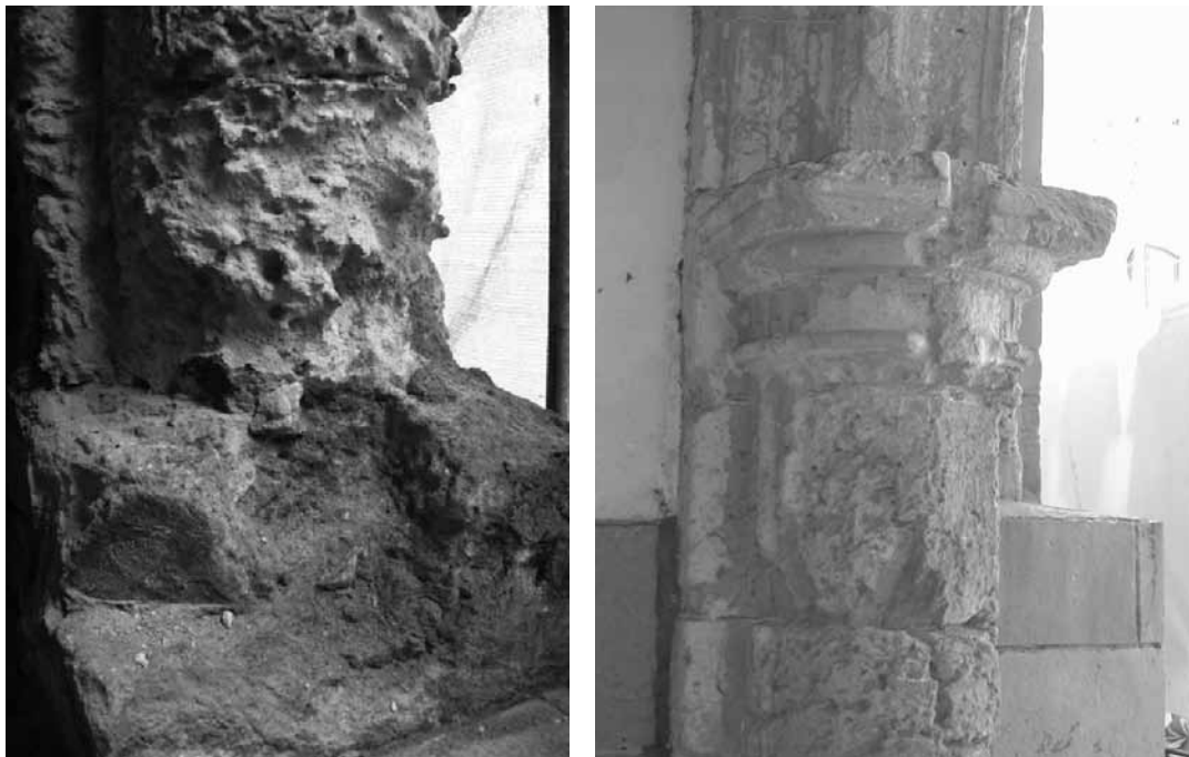
Figura 3. La agresión es tan evidente que los sillares han perdido su forma original completamente
