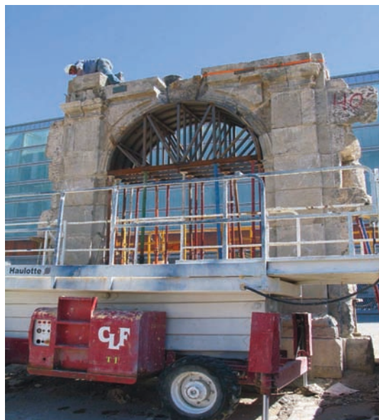
Figura 6: Montaje de la puerta original de acceso al recinto. Fotografía tomada el 30 de septiembre de 2005, cortesía de Ferrovial Agromán .
