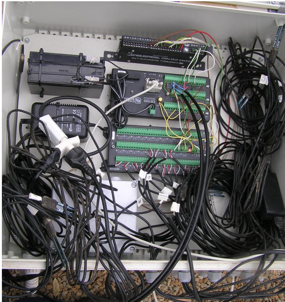
Foto 2. Lugar donde está situado el datalogger CR1000 (Campbell Scientific Inc., Logan, UT), donde van conectados los sensores de humedad del suelo EC-5 (Decagon Devices, Ltd., Pullman, WA).
