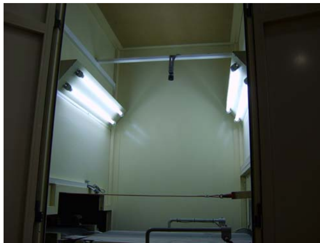
Figura 20. Sistema de iluminación instalado en la planta.
