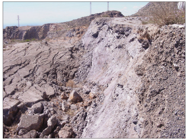
Foto 5.- Rotura plana a favor de la foliación grieta de 100 m que genera un escarpe de 2 m.
