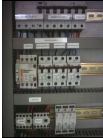
Foto 5.- Parte interior del cuadro eléctrico-anterior al proyecto.
