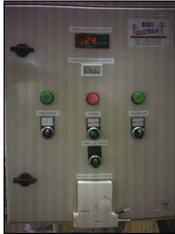
Foto 3.- Puerta principal del cuadro de control anterior al proyecto.
