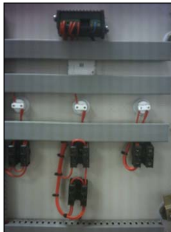
Foto 4.- Conexionado trasero de la puerta principal del cuadro eléctrico anterior al proyecto.
